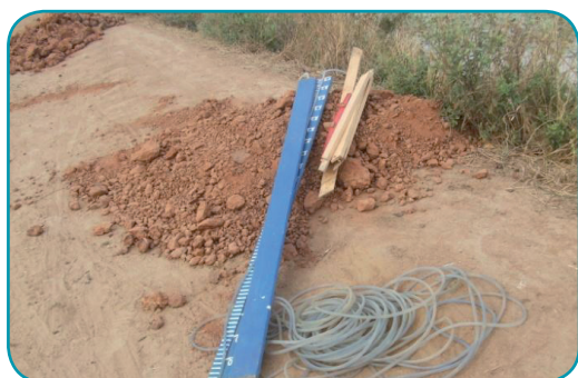
Photo : Outil de diagnostic : Echelle et tuyau transparent pour constituer le niveau à eau. On voit aussi les piquets pour le piquetage.
